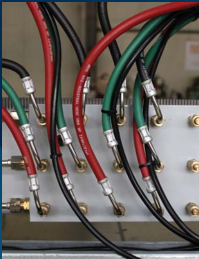
메뉴플러그 방식의 GAS 분배관 적용 분배관 간소화 및 배관의 노후화로 인한 LEAK 현상 개선
